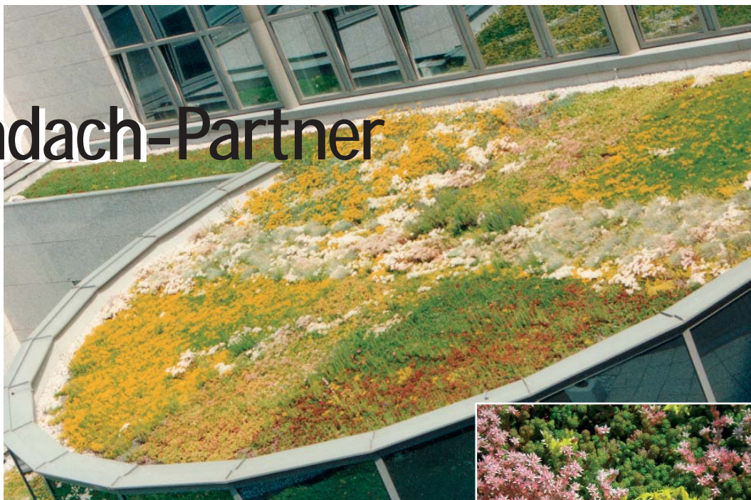
Extensiv begrüntes Flachdach
